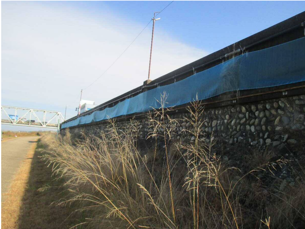
図 15 設置場所①（濃尾大橋下流側堤防）の防虫ネット設置状況
