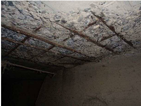
床版の剥離・鉄筋露出
