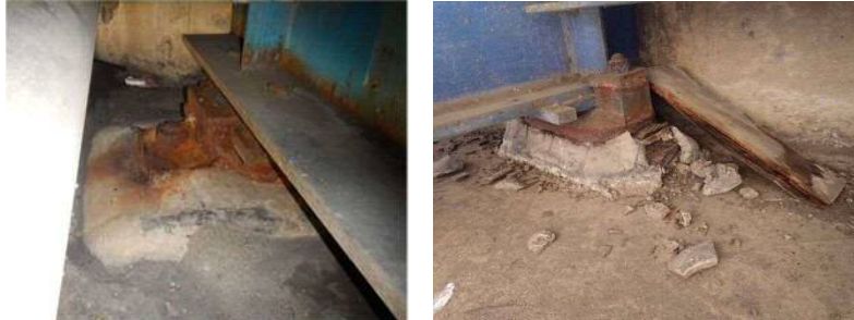
支承の腐食・モルタルの破損
