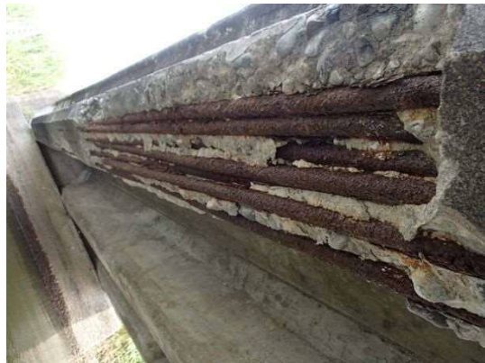
主桁の鉄筋露出
