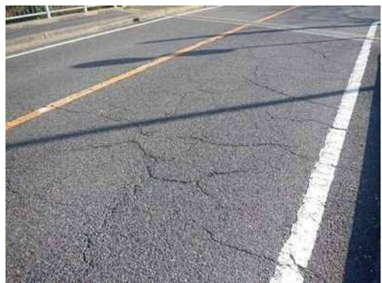
舗装のひびわれ
