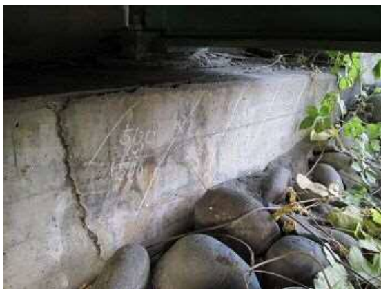
橋台のひびわれ
