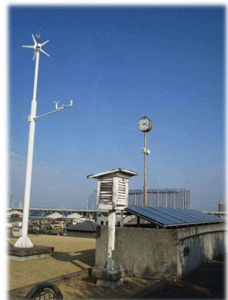
エコハウス138 太陽光・風力発電設備
