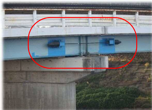
落橋防止システム
