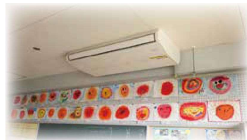
PFI 方式により整備した空調設備
