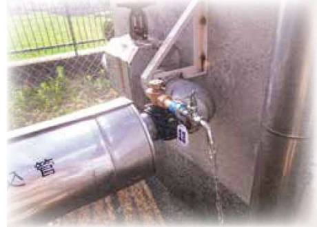
受水槽給水栓
