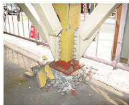
柱の根元が著しく破壊されている。
