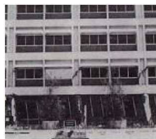
建物全体、又は一部が傾斜している。
