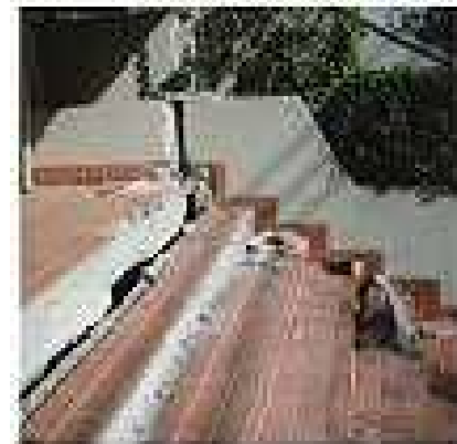
屋外階段が傾斜、破損している。
