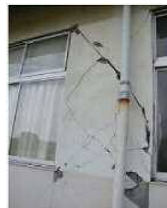
大きなひび割れがある。
