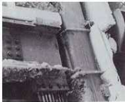
柱と梁の接合部やボルト部材等が破壊されている。
