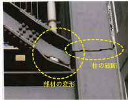
柱と柱を固定する重要な部材が変形、又は破断している。
