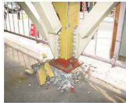
柱の根元が著しく破壊されている。
