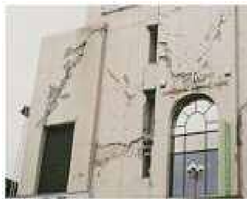
モルタルやタイル等にひび割れや剥離等がみられる。
