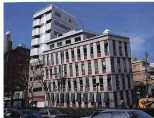
建物全体、又は一部が傾斜している。
