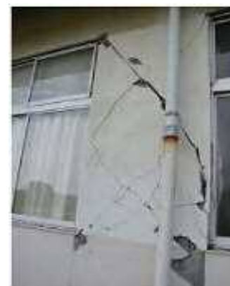
大きなひび割れがある。
