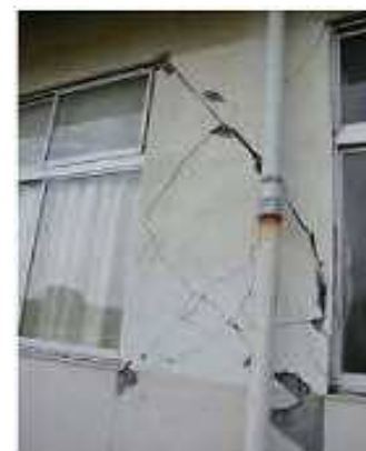
大きなひび割れがある。
