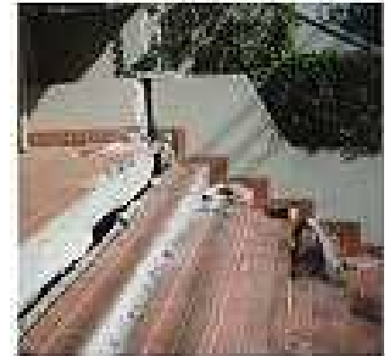
屋外階段が傾斜、破損している。
