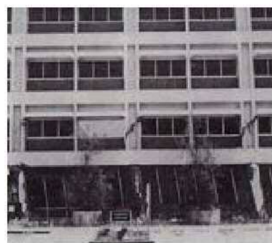
建物全体、又は一部が傾斜している。
