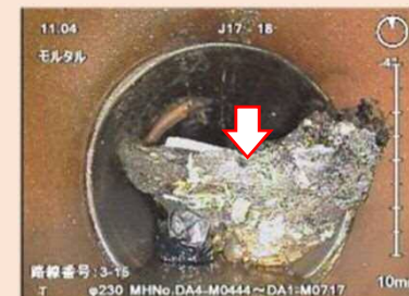
異物が混入した下水道管
