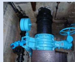
配水場の緊急遮断弁設置状況
