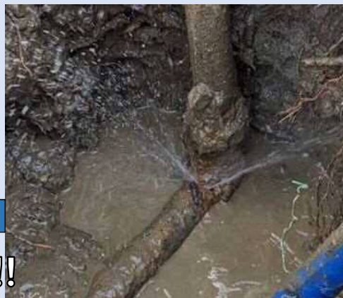
水道管の破損
