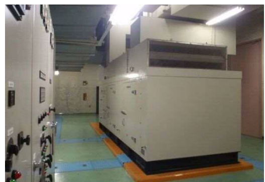
非常用発電機
