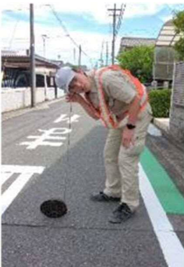
音聴棒にて仕切弁の漏水音を確認
