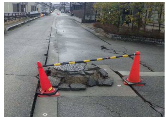
液状化により浮上したマンホール
