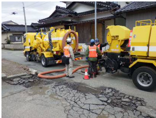
TVカメラによる被害状況調査
