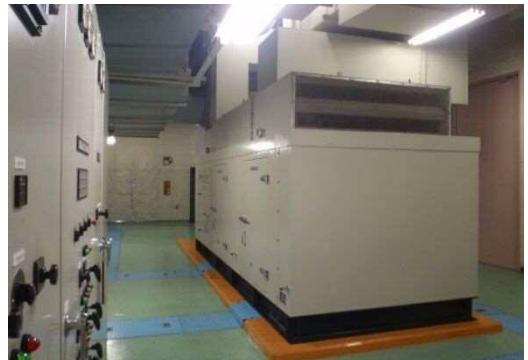
非常用発電機
