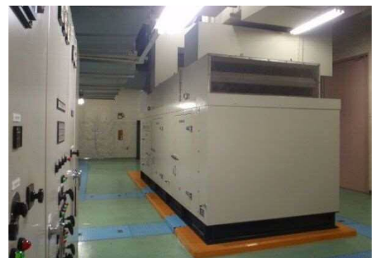
非常用発電機
