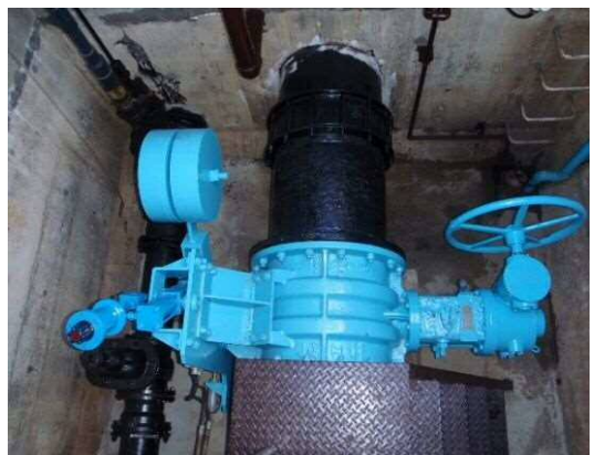
配水場の緊急遮断弁設置状況
