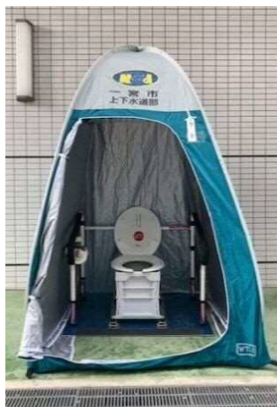
災害用マンホールトイレ設置例
