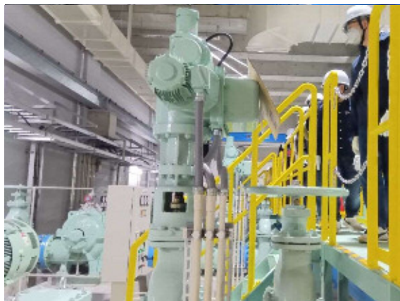
佐千原浄水場ポンプ棟ポンプ室
