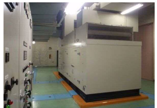
非常用発電機
