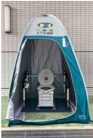
災害用マンホールトイレ設置例
