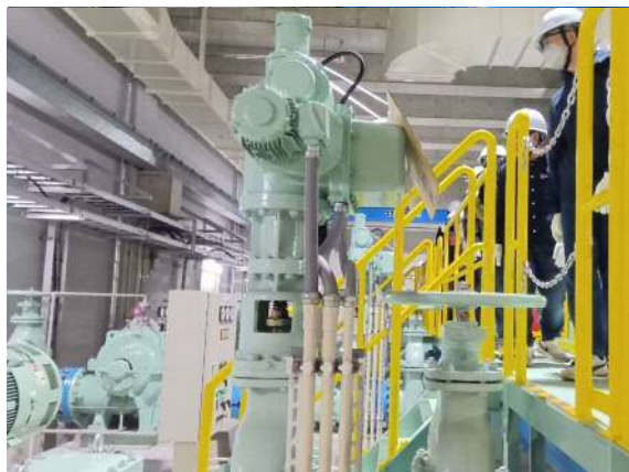
佐千原浄水場ポンプ棟ポンプ室
