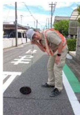
音聴棒にて仕切弁の漏水音を確認
