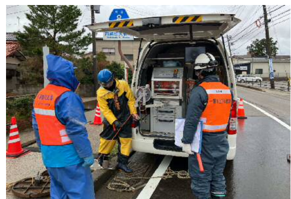
TVカメラによる被害状況調査
