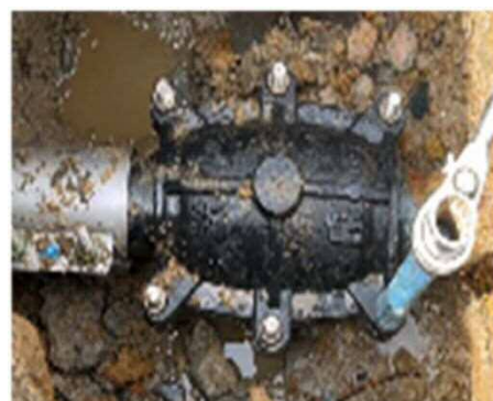
漏水が発見されたら速やかに修繕を行います。
