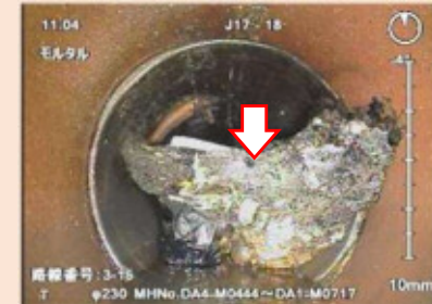
異物が混入した下水道管
