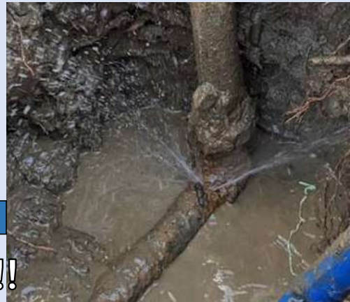
水道管の破損
