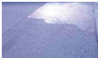
道路上の水道漏水
