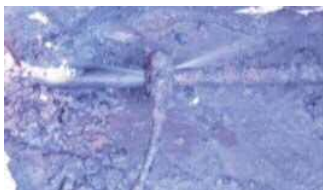
地中で漏水していた水道管
