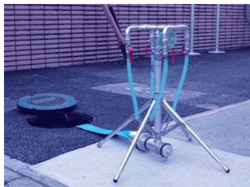
緊急給水施設の設置状況
