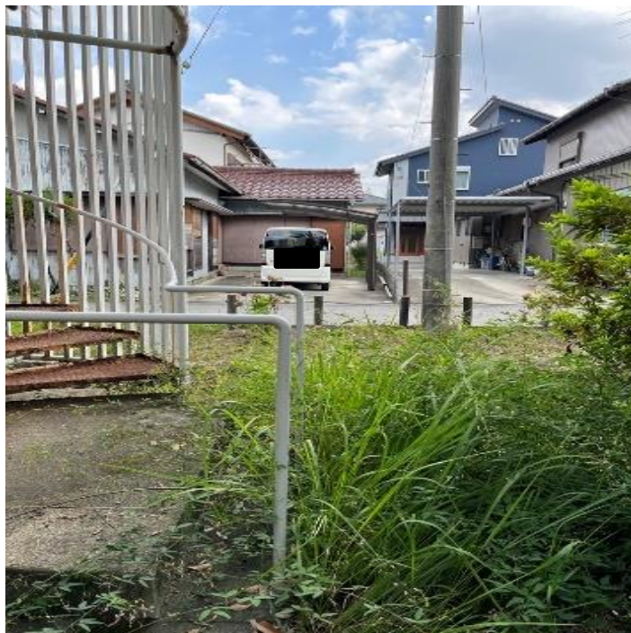
【図表 4-4-19】 非常階段の現状 3
