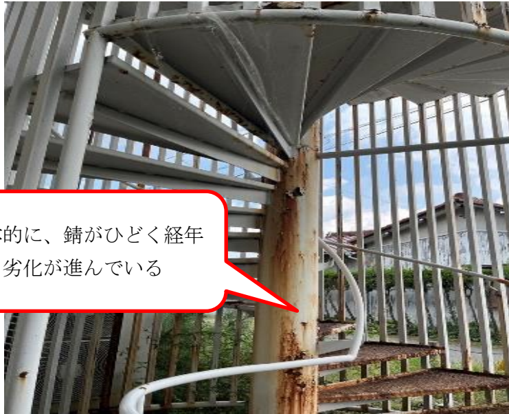
【図表 4-4-17】 非常階段の現状 1
