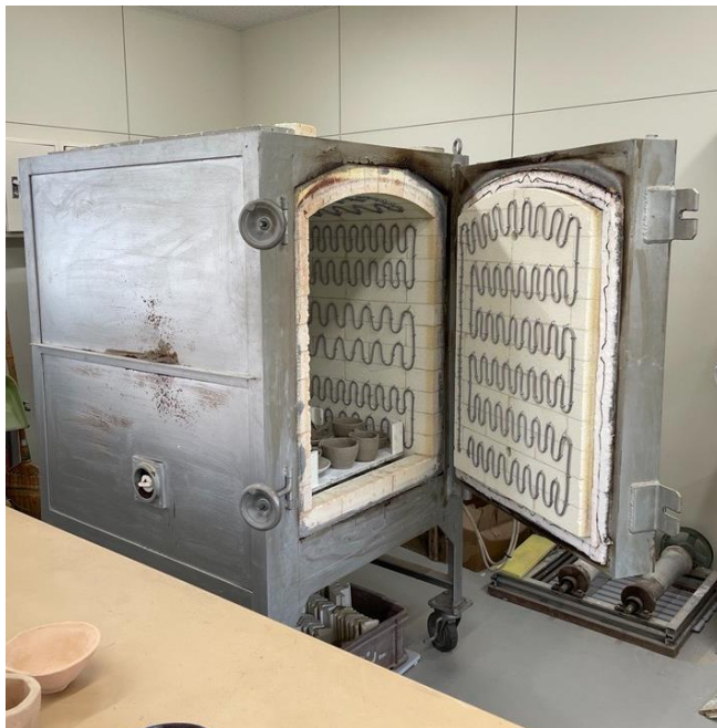
【図表 4-4-12】 朝日西つどいの里 陶芸室の管理ラベルのない電気釜
