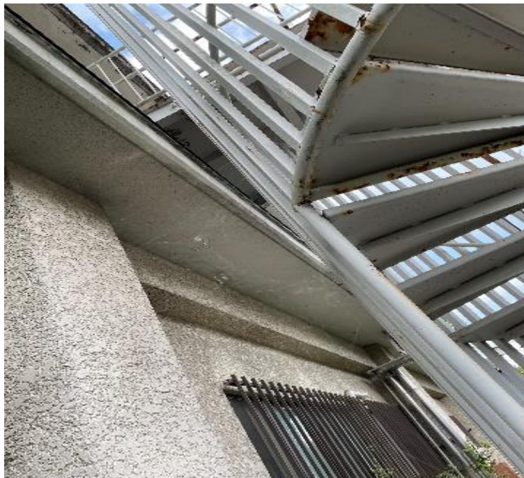
【図表 4-4-18】 非常階段の現状 2
