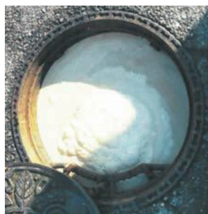
詰まりにより溢れる 寸前の汚水
