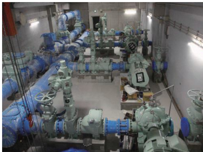
ポンプ棟内の機械設備
