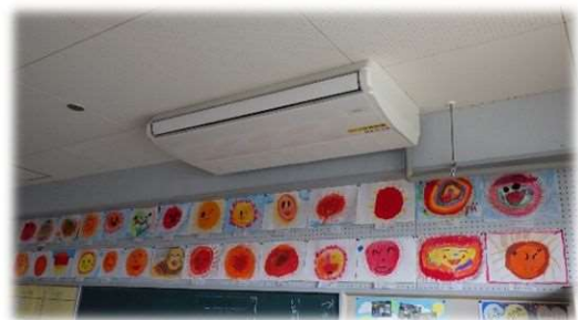
PFI 方式により整備した空調設備
