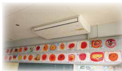
PFI 方式により整備した空調設備
