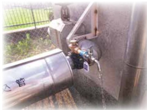
受水槽給水栓
