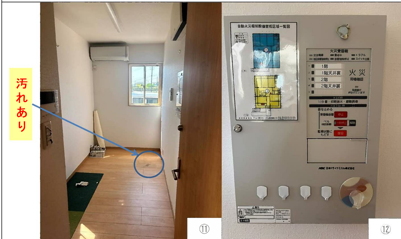
写真⑥ 1階事務室、消防設備
