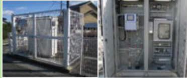
水質監視装置(市内14か所)
