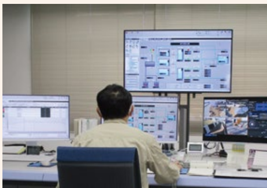
【管理棟・新中央監視室】
