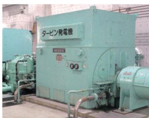
▲タービン発電機
