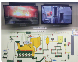
▲焼却炉の中央制御盤
