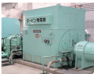
▲タービン発電機
