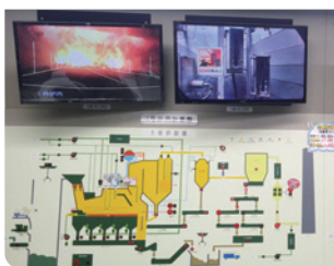
▲焼却炉の中央制御盤
