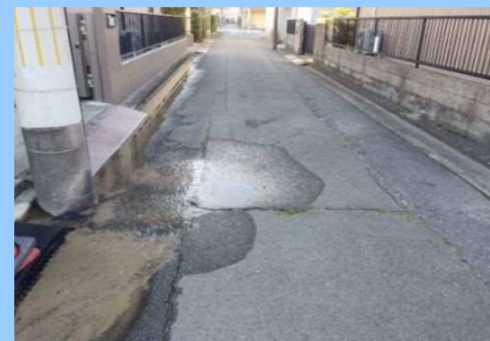
水道管の老朽化に伴う漏水
