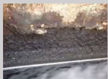
コンクリート 躯体腐食
