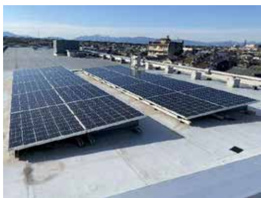
太陽光パネル（学校の屋上）
