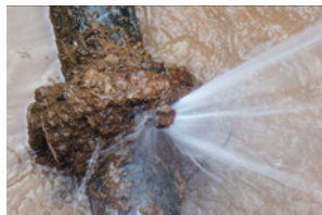
老朽化し漏水した水道管▶
