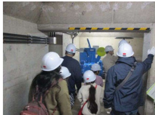
配水塔地下の緊急遮断弁見学
