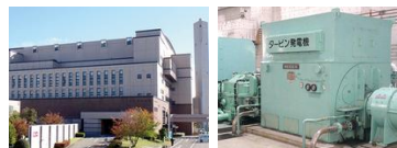
公共施設に電力供給
