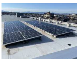
太陽光パネル (学校の屋上)
