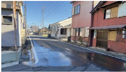
道路漏水の例
