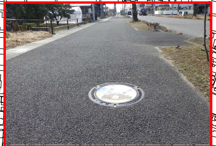
下水デザインプレート設置写真
