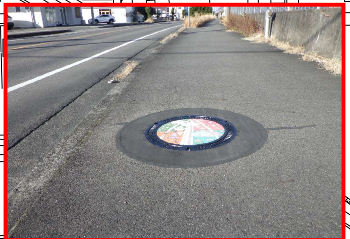
下水デザインプレート設置写真
