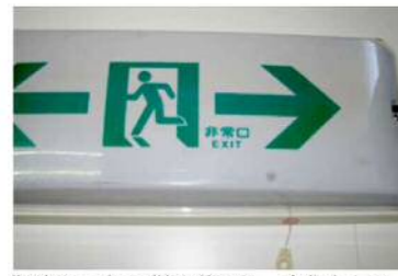
蛍光灯使用誘導灯
