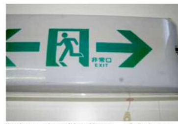
蛍光灯使用誘導灯
