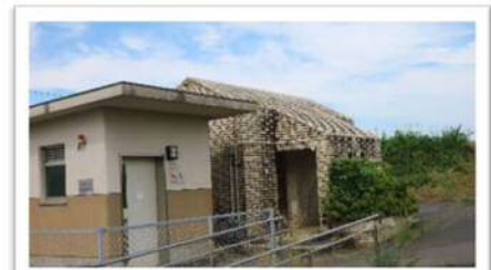
老朽化した堤外地のトイレ
