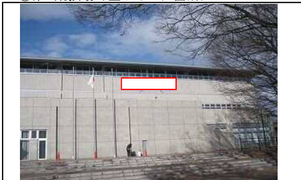
2-①第2競技場外壁サイン(1箇所)
