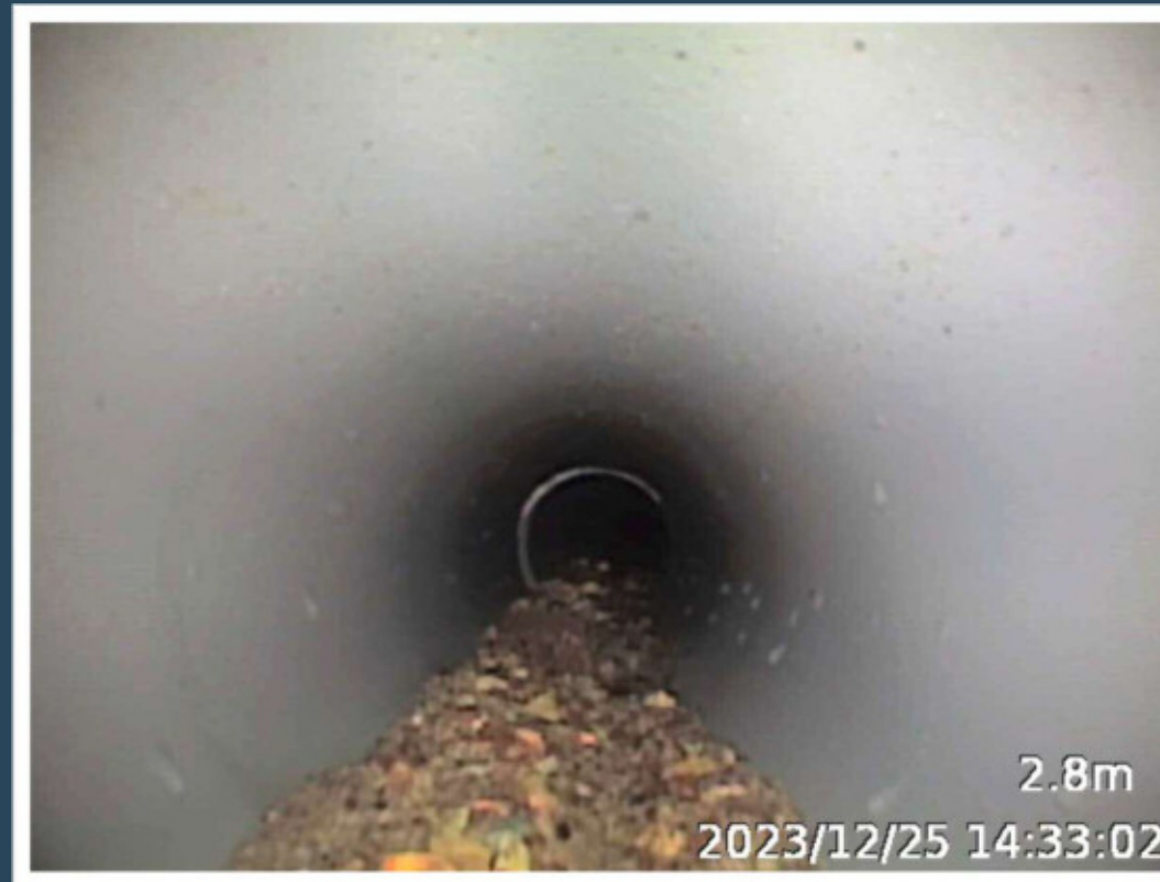
【取付管内に土砂堆積】
