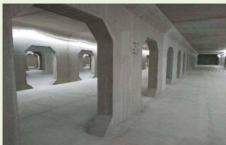
〔雨水貯留槽(内部)〕 〔イメージ〕
