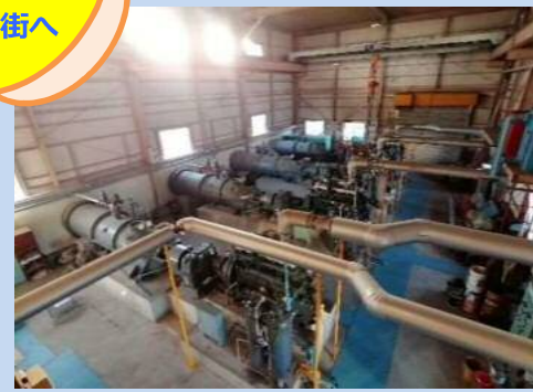
〔老朽化したポンプ設備(旧西萩原ポンプ場)〕
